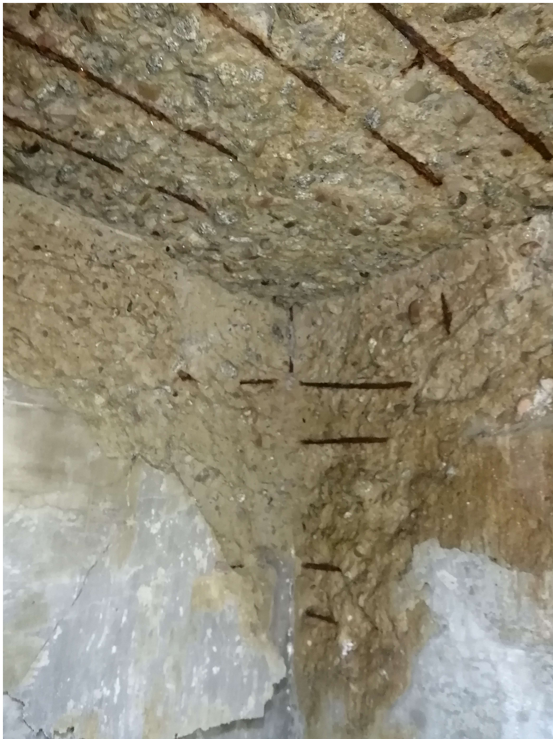
Fot.5 Wewnętrzne uszkodzenia konstrukcji studzienki drenażu.
