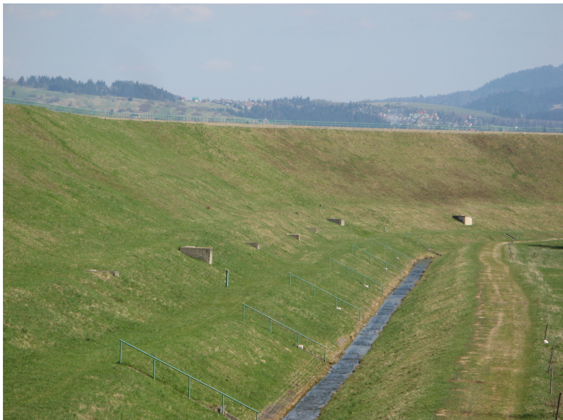
Fot.1 Widok na skarpe odpowietrzoną z półką pośrednią, rów nr B i nierównomierne wystawione studzienki kontrolne drenażu.
