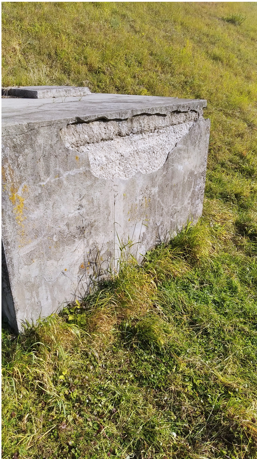
Fot.4 Zewnętrzne uszkodzenia konstrukcji studzienki drenażu.
