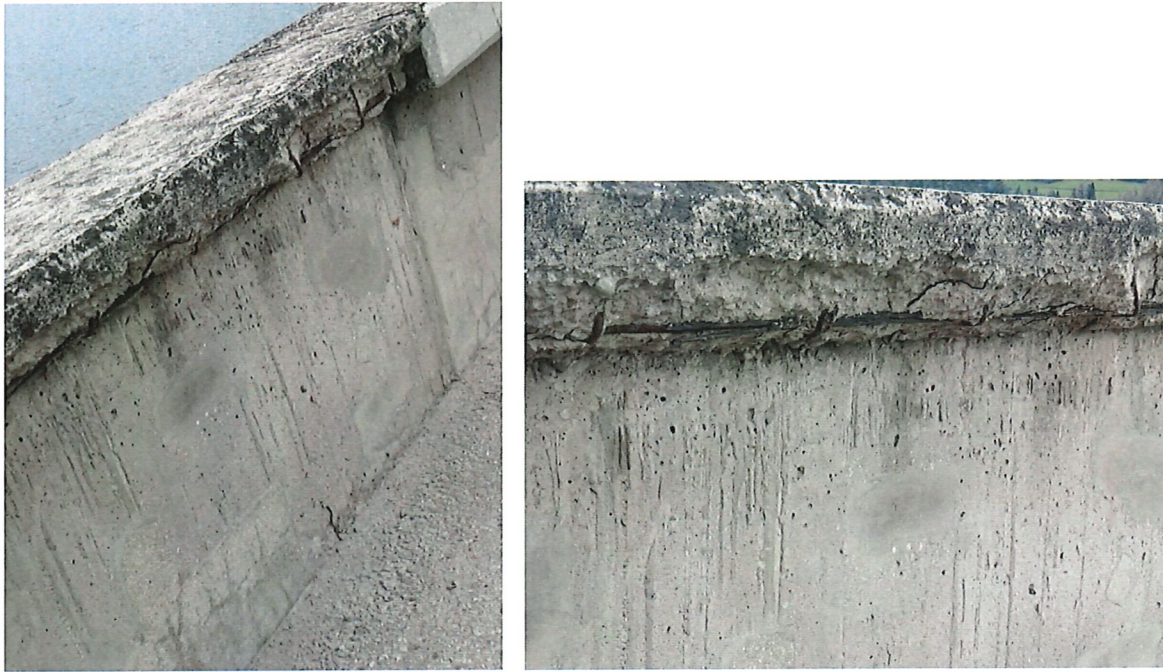
Fot . 3 i 4 Falochron uszkodzenia korony.
