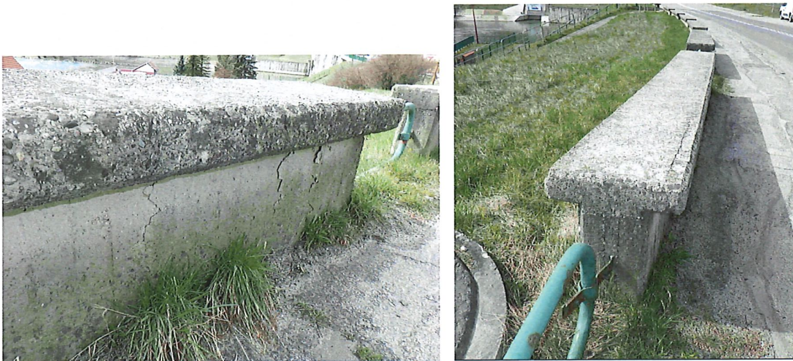
Fot . 5 i 6 Parapet zapory lewostronnej uszkodzenia powierzchni.
